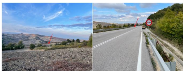
Figura 15. Evidenze di possibili movimenti franosi presenti, rispettivamente, a nord ed a nord-est del viadotto Santa Lucia.
